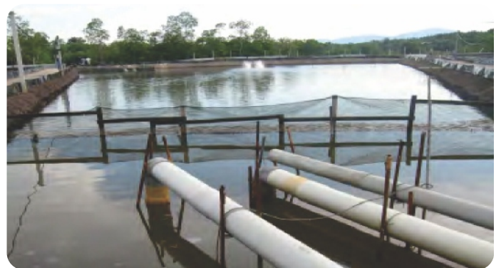
Figura 12.27 – Alagamento de grandes áreas
