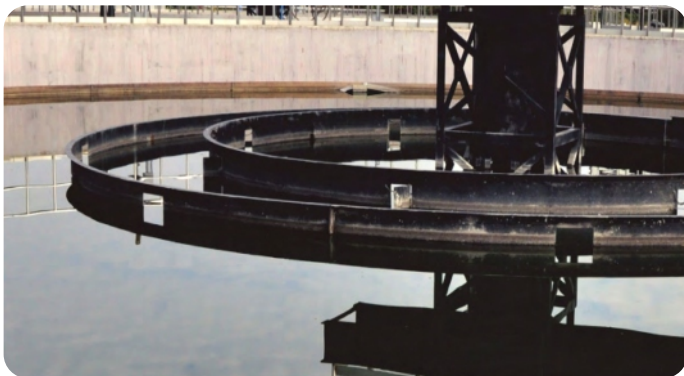
Figura 12.35 – Grandes estações de tratamento
