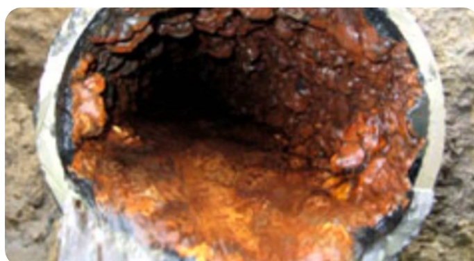
Figura 13.17 – Exemplos de tubulações entupidas
