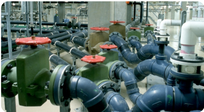
Figura 12.12 – Bombeamento de água potável
