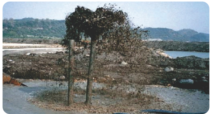
Figura 12.40 – Bombeamento de água servida
