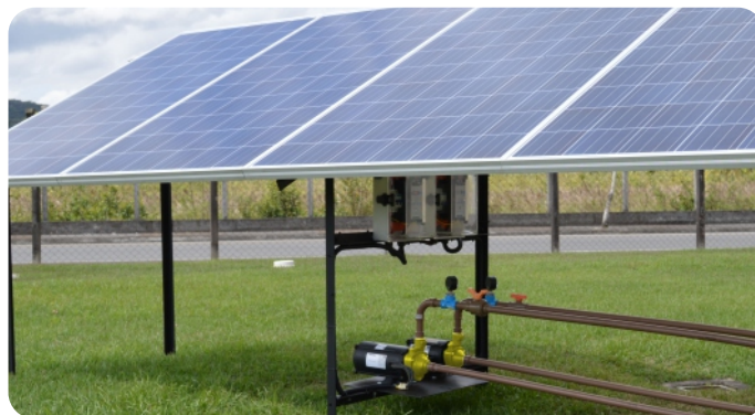
Figura 12.58 – Conjunto de bombeamento solar
