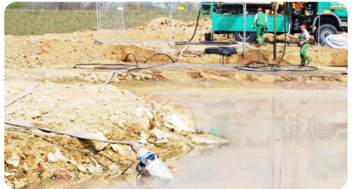
Figura 12.38 – Esgotamento de água residual
