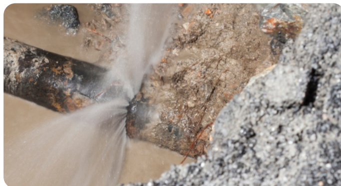
Figura 13.16 – Pontos de vazamento na tubulação
