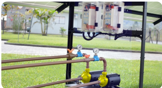
Figura 12.57 – Bombas a energia solar
