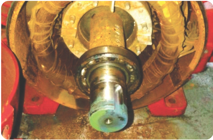
Figura 13.12 – Motor completo com presença de umidade
